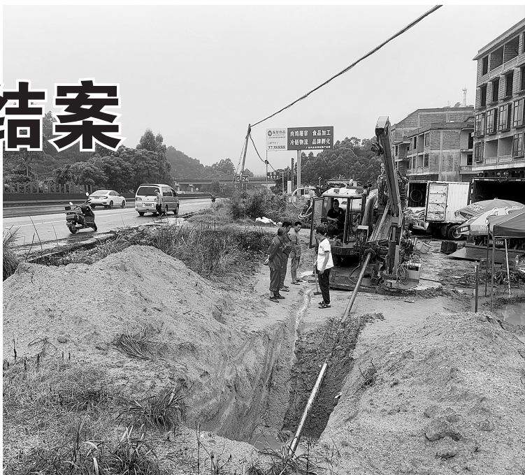
公路执法人员对违法挖掘公路用地的行为进行制止。(钟安杰 摄)
