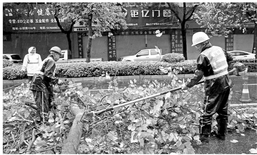
公园路有树木倒下,影响道路通行,园林工人和交警共同清障保畅通。
