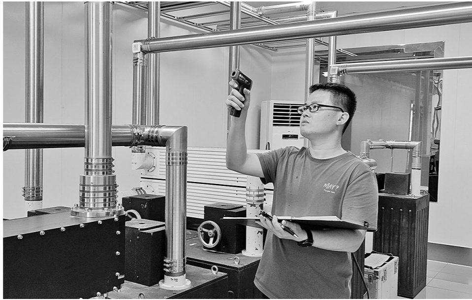
蒋明对台站机房设备进行例行安全检修。
