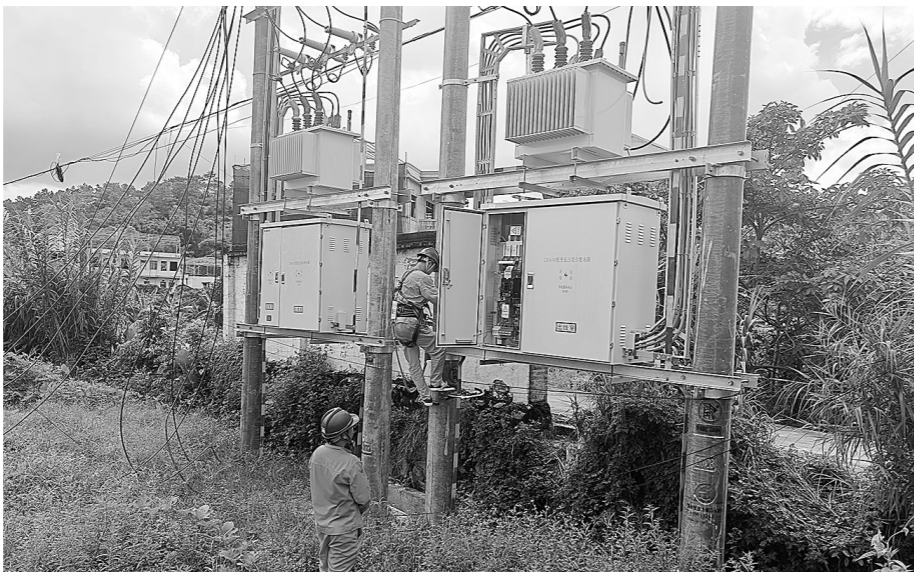
改造完成的变压器规范而美观。
